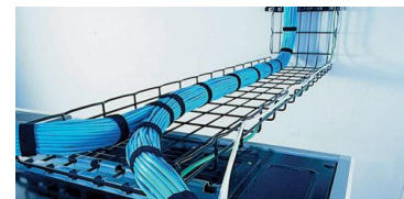
Assurer la distribution des flux électriques
