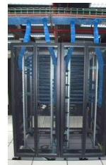
Cheminement de câble
